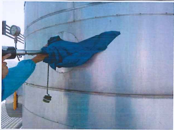
5#废气排放口 (FQ-571-6)
