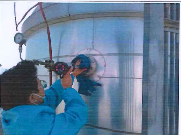
7#废气排放口 (FQ-571-8)
