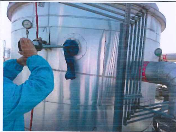
3#废气排放口 (FQ-571-4)
